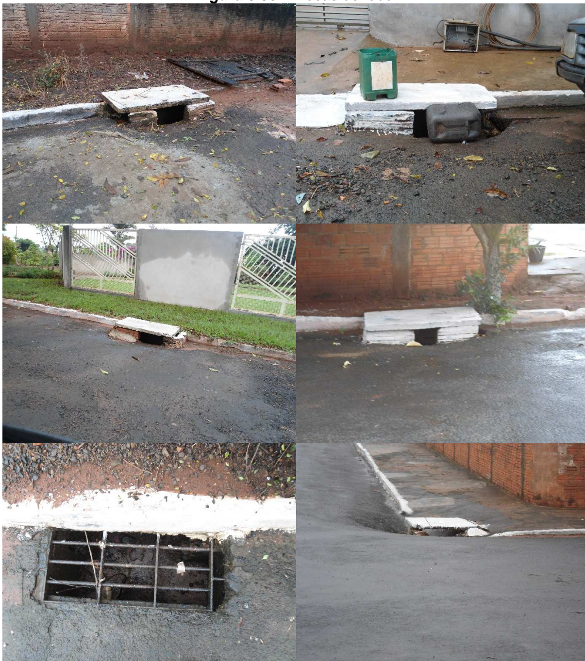
Figura 3.35 – Bocas de lobo.
